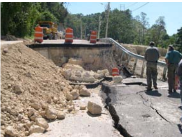
Deslizamiento en la PR111 para el año 2004. Foto por: Rafael J. Morales
